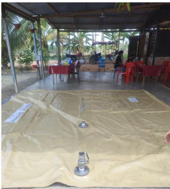
Instalación de tanques flexibles de 10,000m 3 en zonas críticas de la Sede Central durante el periodo de sequía en coordinación con la Dirección Regional de Vivienda
